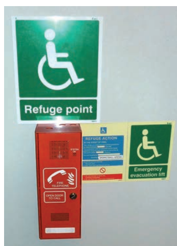
Señalización de zona de refugio.
